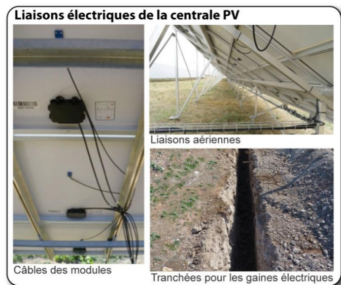
Photographie 4 : Liaisons électriques
