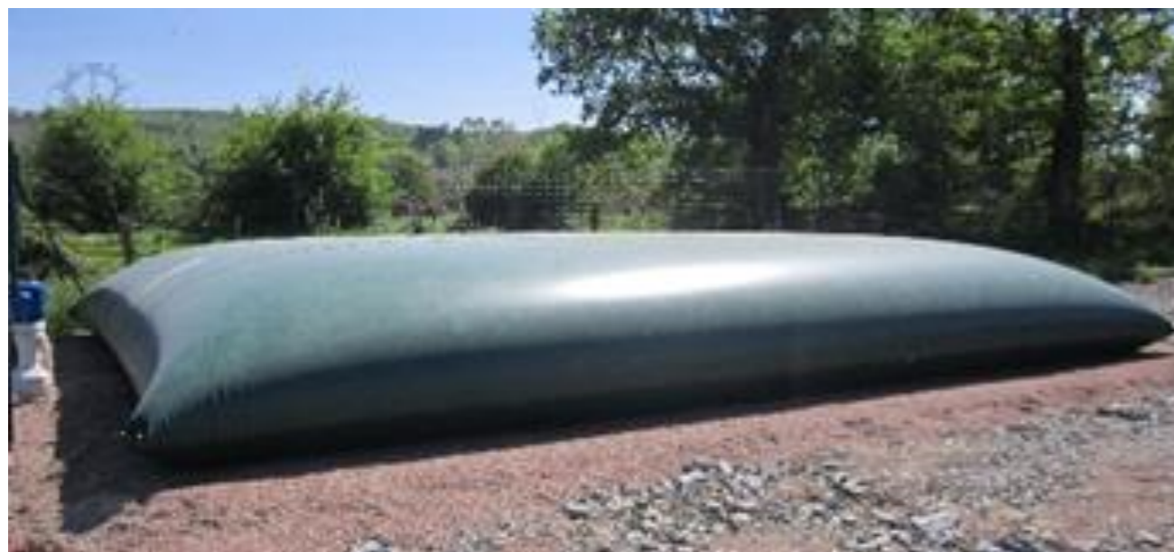
Photographie 6 : Réserve incendie
